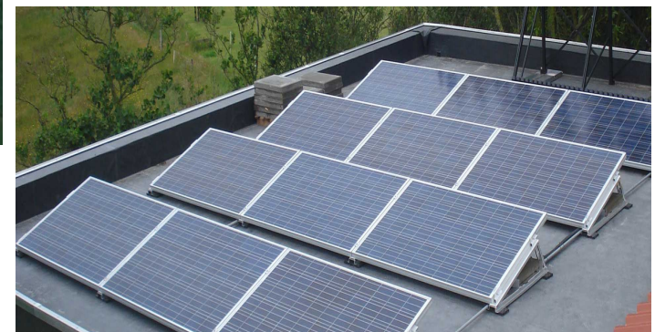
STAP 4: Lokaal zonnepanelen
